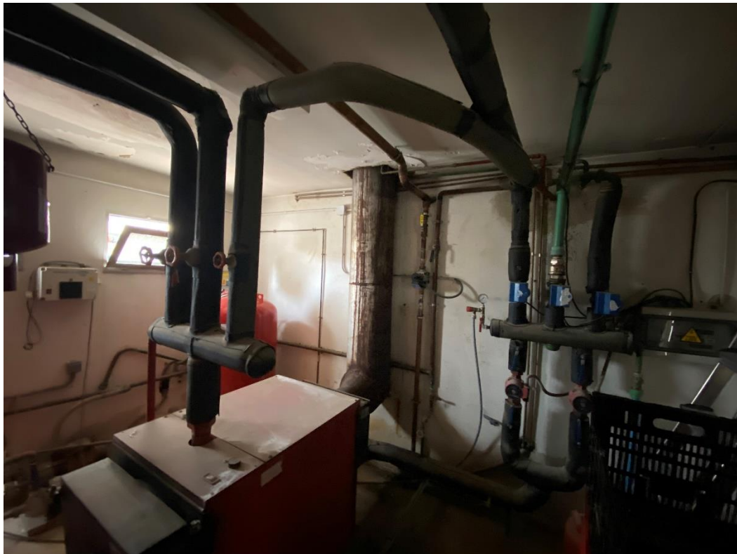
Detalle 1. Sala Maquinas
