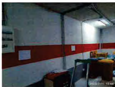
Reforç de lluminàries zona bancs de treball
