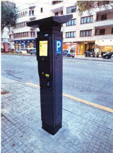
Instal·lació del primer expenedor C/Manacor 4-6
