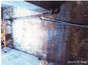
Aspecte filtracions mur nord PI 1.
